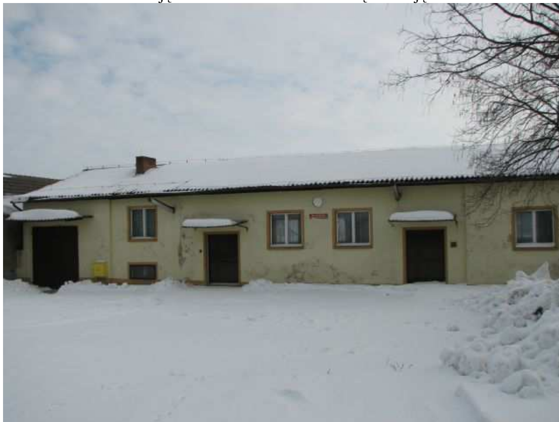
Zdjęcie Nr 3 Widok na zniszczoną elewację
